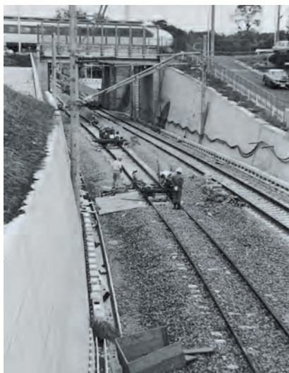
いずみ野線の建設工事(1975年)。東海道新幹線の下を通る南万騎が原駅付近
